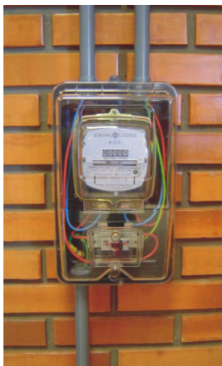
Caixa Monofásica instalada na parede, em área urbana.
