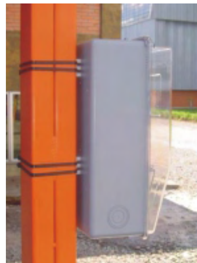
Caixa Polifásica instalada em poste, com o Kit de Fixação Cemar.
