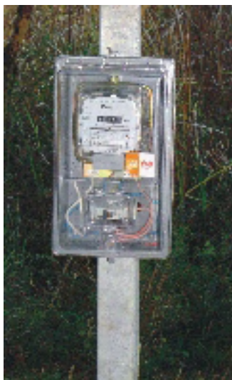
Caixa Monofásica instalada em poste quadrado de metal, em área rural.
