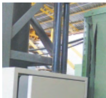
Eletrodutos com quadros de distribuição, instalados em ambientes industriais
