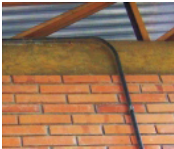
Eletrodutos em curva, instalados ao tempo
